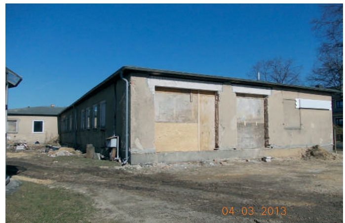
Abb. 2: Sanierungsprojekt Radiosondenprüfzentrale nach 4 Bauwochen; die Durchbrüche zum Anbau mit zukünftigem Haupteingang sind bereits geschaffen; das Fundament für den Anbau wird Ende März gegossen (Foto: Stiller 4.3.13).
